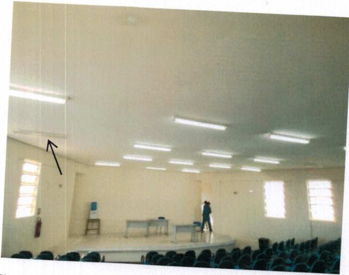
Figura 46 – Foto Da Auditório : Lâmpada queimada - AUDITÓRIO
