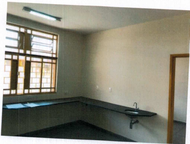
Figura 36 – Foto da Parede: Bancadas desniveladas - SALA DE CURATIVOS
