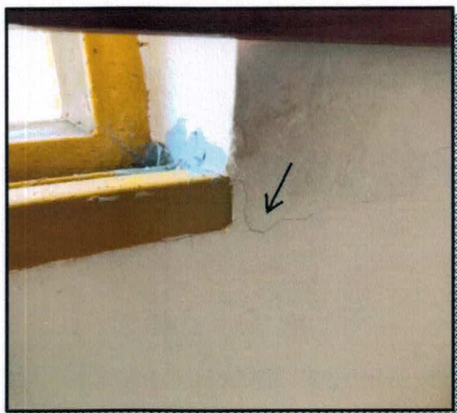
Figura 1 – Foto da Parede: Fissura da esquadria - DML
