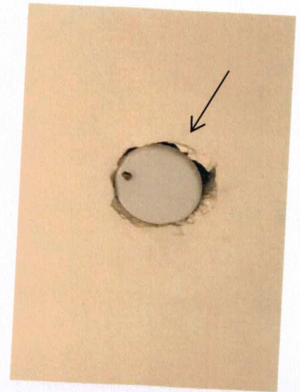
Figura 47 – Foto Do Forro : Forro de gesso com furo maior que a tampa cega - FORRO SALA
