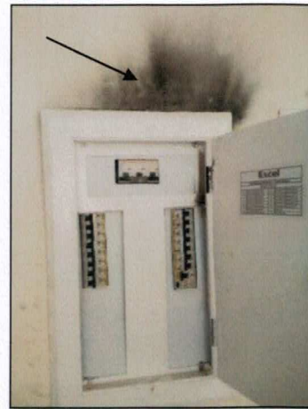
Figura 29 – Foto da Parede: Quadro de distribuição com sinais de explosão – REFEITÓRIO
