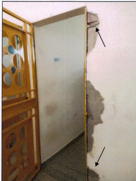
Figura 30 – Foto da Grade: Chumbadores expostos – DORMITÓRIO ALA B
