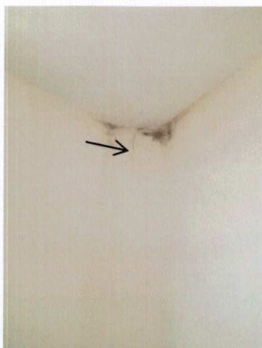
Figura 7 – Foto da Parede: Infiltração na laje - SALA DE AULA
