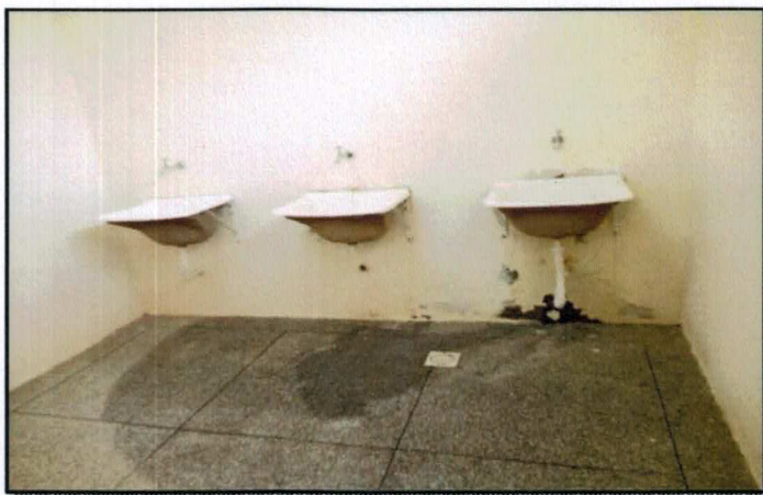
Figura 19 – Foto da Parede: Infiltração em área molhada – LAVANDERIA
