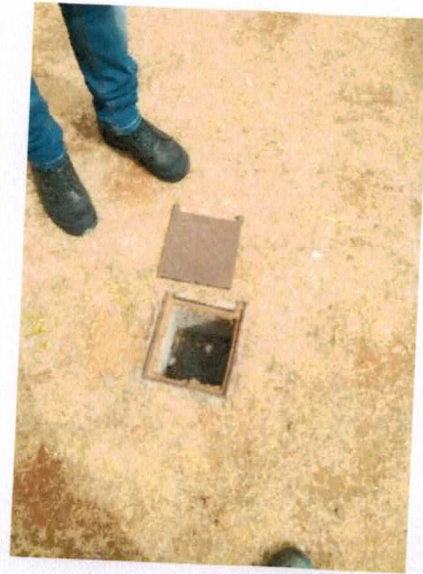
Figura 51 – Foto Do Pátio : Tampa da caixa de aterramento quebrada - PÁTIO
