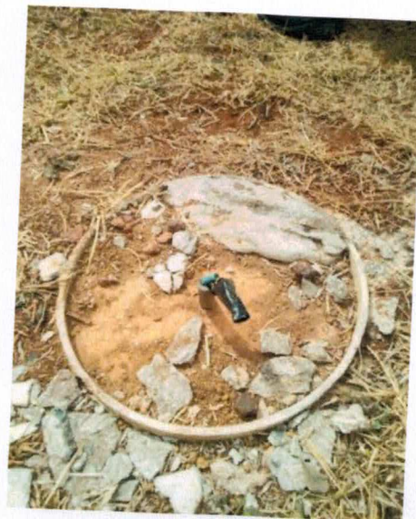
Figura 43 – Foto do Pátio: Fiação exposta - PÁTIO
