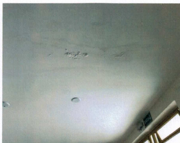
Figura 22 – Foto da Laje: Infiltração na laje, presença de bolhas na pintura - HALL
