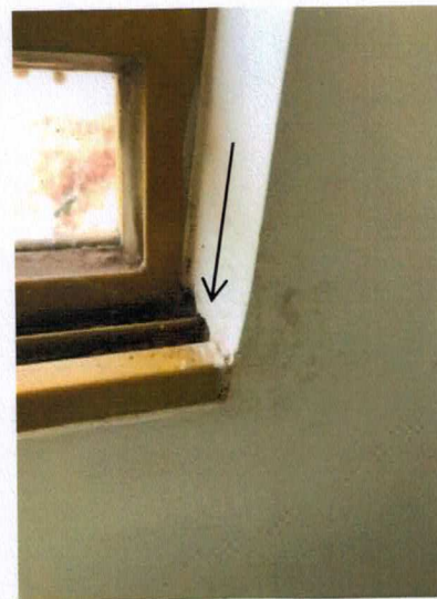
Figura 10 – Foto da Parede: Infiltração no canto inferior da esquadria - SALA DE AULA
