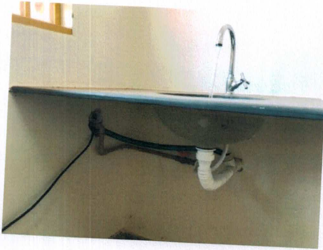
Figura 34 – Foto da Parede: Instalação hidráulica inacabada - SALA DE CURATIVOS
