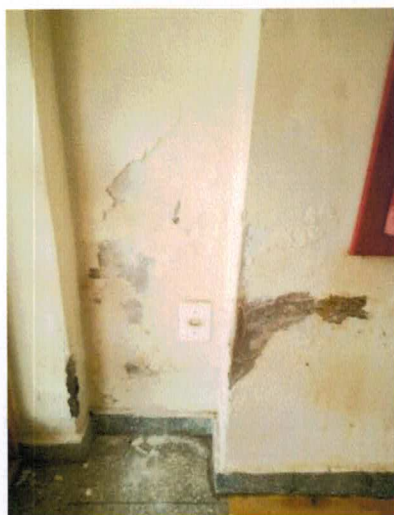
Figura 25 – Foto da Parede: Infiltração parede do hidrante - SALA DE ATIVIDADES
