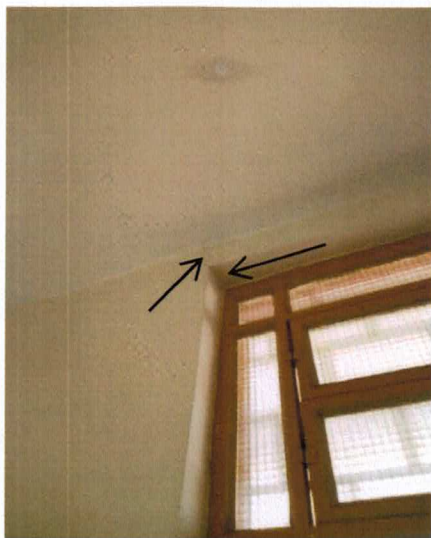
Figura 13 – Foto da Parede: Fissura acima da esquadria - SALA DO AGENTE
