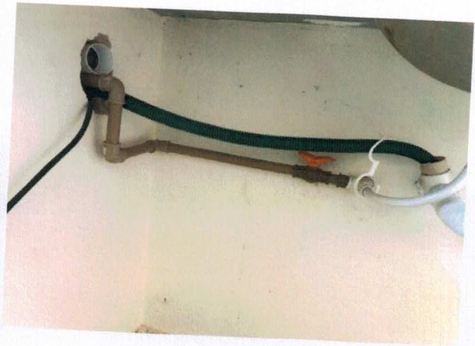
Figura 35 – Foto da Parede: Instalação hidráulica improvisada - SALA DE CURATIVOS
