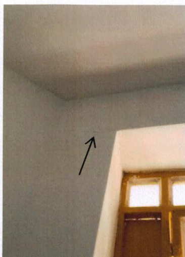
Figura 15 – Foto da Parede: Fissura acima da esquadria - DORMITÓRIO
