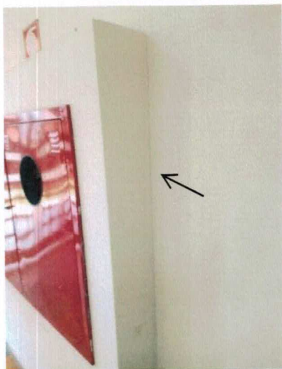
Figura 11 – Foto da Parede: Fissura na junção da parede do abrigo de hidrante - RECEPÇÃO
