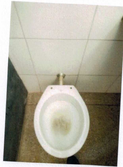
Figura 55 – Foto Do Piso : Teste em vaso sanitário para verificação de funcionamento de descarga - DORMITÓRIO
