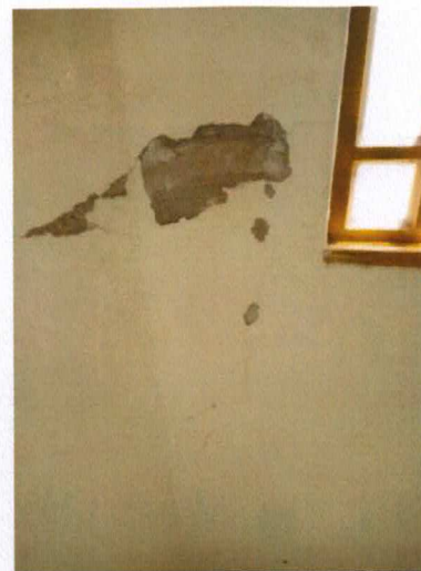
Figura 26 – Foto da Parede: Infiltração ao lado da esquadria - SALA DE AULA
