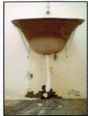
Figura 20 – Foto da Parede: Foto aproximada da infiltração – LAVANDERIA
