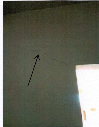
Figura 18 – Foto da Parede: Fissura acima do requadro - ALA C
