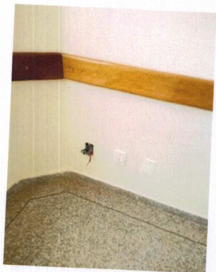
Figura 44 – Foto da Parede : Fiação exposta - SALA DE AULA
