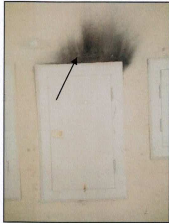
Figura 28 – Foto da Parede: Quadro de distribuição com sinais de explosão – REFEITÓRIO
