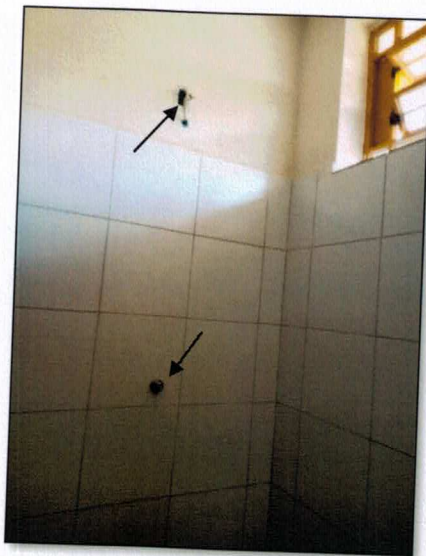
Figura 32 – Foto do Banheiro: Falta dos equipamentos Hidráulicos – DORMITÓRIO ALA B
