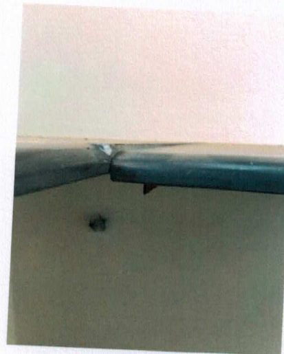
Figura 37 – Foto da Parede: Bancada desnivelada, foto aproximada - SALA DE CURATIVOS
