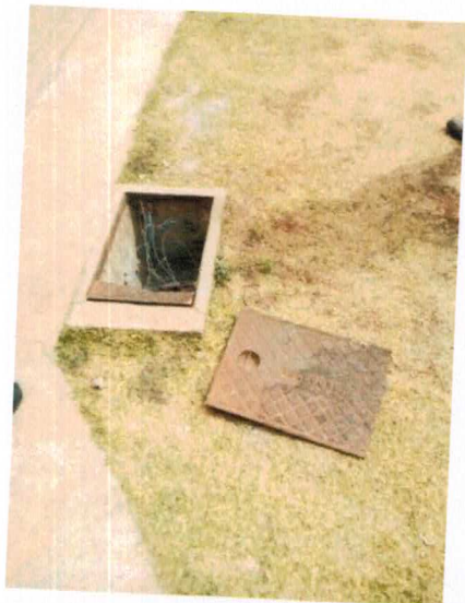
Figura 42 – Foto da Pátio: Tampa de caixa de passagem quebrada - PÁTIO
