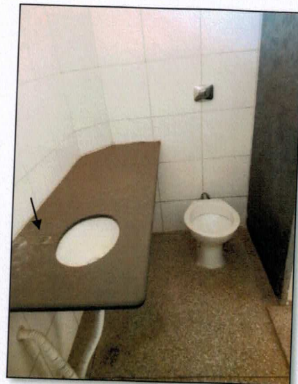
Figura 33 – Foto do Banheiro: Falta dos equipamentos Hidráulicos – DORMITÓRIO ALA B
