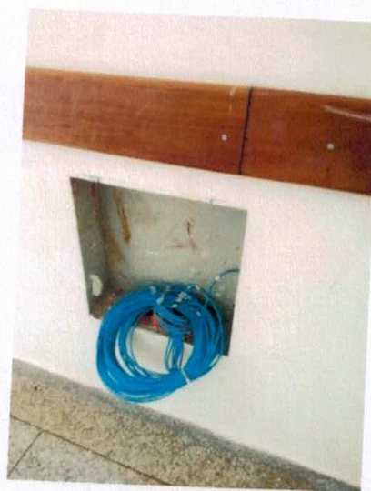
Figura 45 – Foto Da Parede : Fiação exposta, ausência da tampa do quadro - PÁTIO
