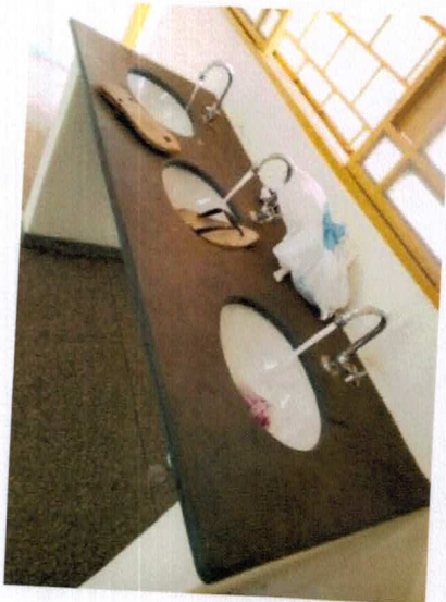
Figura 52 – Foto Da Parede : Teste em pias para verificação do funcionamento das torneiras - REFEITÓRIO
