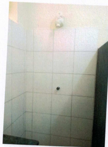
Figura 53 – Foto Da Parede : Teste em banheiros para verificação do funcionamento dos chuveiros - DORMITÓRIOS ALA C
