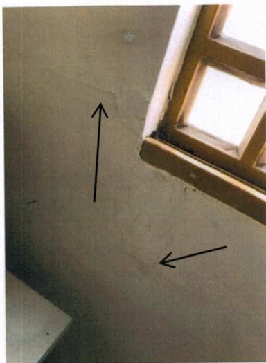
Figura 9 – Foto da Parede: Fissuras verticais e inclinadas abaixo da esquadria - SALA DE AULA
