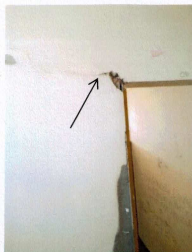
Figura 8 – Foto da Parede: Fissura na alvenaria acima da porta - DORMITÓRIO ALA B
