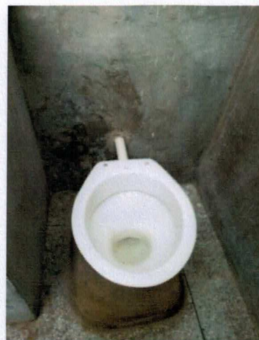
Figura 24 – Foto da Parede: Infiltração na parede do banheiro - ALOJAMENTOS ESPECIAIS
