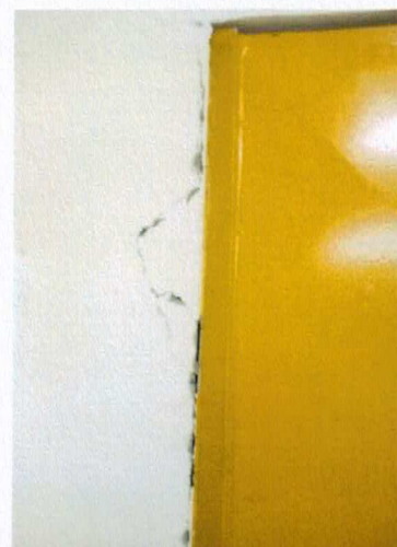
Figura 16 – Foto da Parede: Fissura ao lado da porta - BIBLIOTECA
