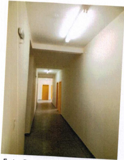
Figura 54 – Foto Da Laje : Teste em luminárias para verificação do funcionamento das lâmpadas - CIRCULAÇÃO
