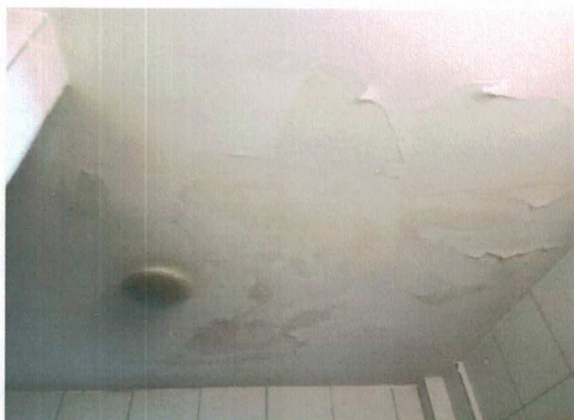
Figura 21 – Foto da Laje: Infiltração na laje - SALA DE AULA
